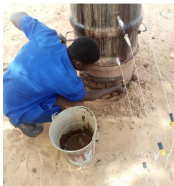
Figure 13: Fermeture des entrées d'air
